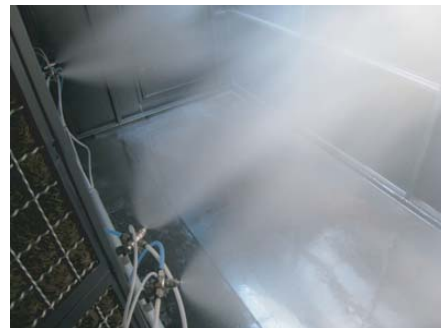
ダクト内噴霧の様子
