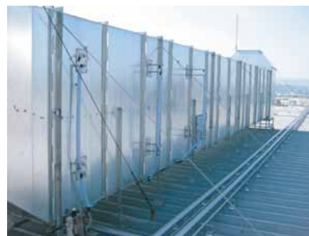
消臭剤噴霧ダクト
