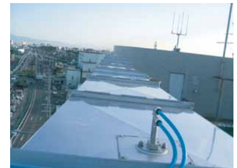
ノズル取付ダクト
