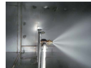
ダクト内の噴霧の様子
