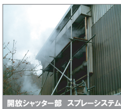
開放シャッター部 スプレーシステム
